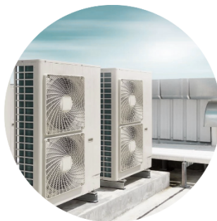
Bombas de calor centralizadas
