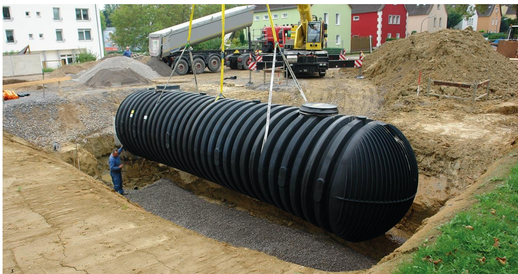
Figura 21. Ejemplo de un tanque de acumulación de aguas pluviales de gran capacidad. Fuente: (GRAF, 2024).
